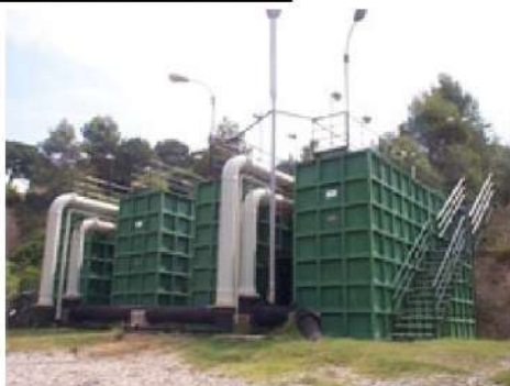
Filtres de sorra per tractar l'aigua que prové dels pous, Abrera.
