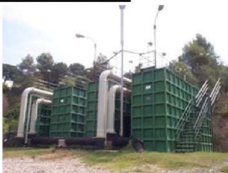
Filtres de sorra per tractar l'aigua que prové dels pous, Abrera.
